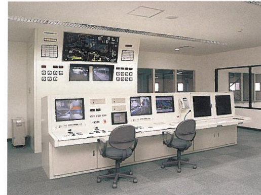
中央操作室 Control room
