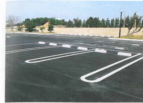
スラグ入アスファルト舗装 ( 駐車場 ) Slag mixed Asphalt ( Parking Area )
