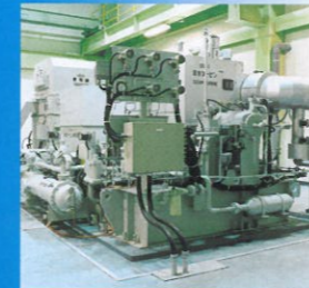
蒸気タービンと発電機 Steam Turbine and Generator
