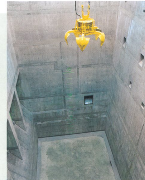
ごみビット Refuse Bunker
