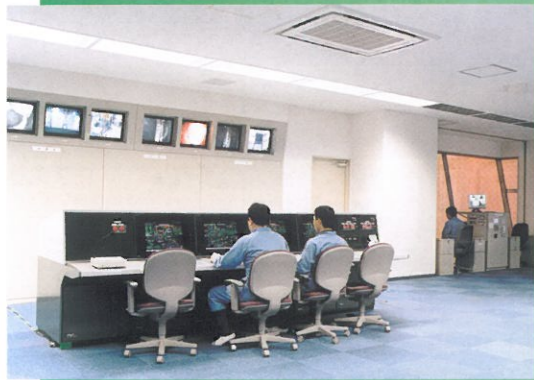
中央操作室 Central Control Room
