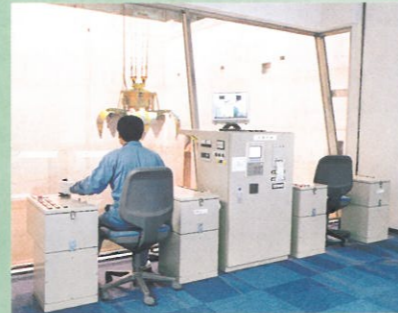
クレーン操作室 Refuse Crane Operation Room
